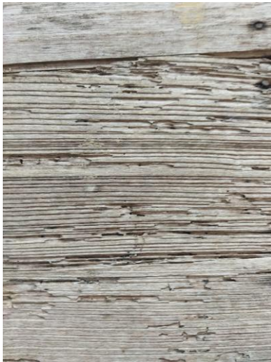
Gambar 12. Jalur makan tak beraturan pada bagian dinding rumah
