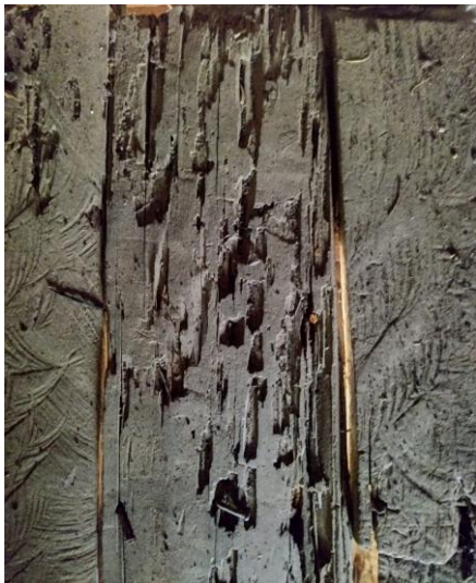
Gambar 6. Gigitan rayap pada bagian lantai rumah
