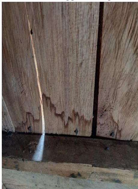
Gambar 10. Jalur makan tak beraturan pada bagian dinding rumah
