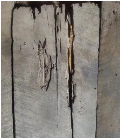
Gambar 8. Gigitan rayap pada bagian lantai rumah
