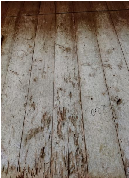
Gambar 4. Bagian dinding berlubang kecil dan tampak lapuk atau keropos
