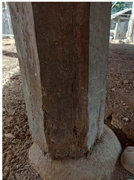
Gambar 11. Lubang kecil dan tanah dibagian bawah tiang
