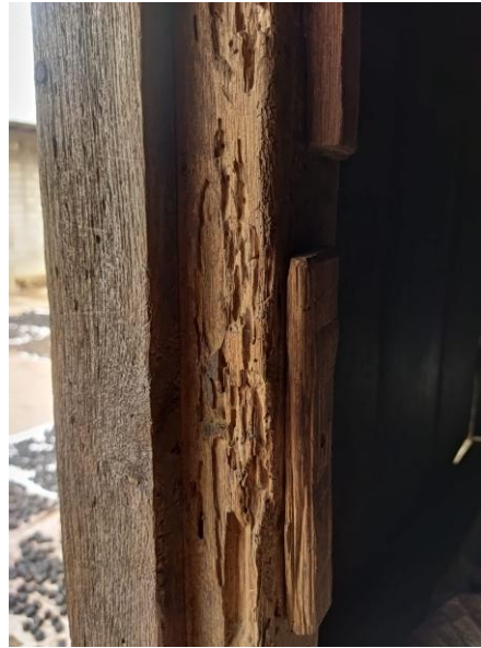
Gambar 5. Bagian kusen jendela terkikis berrongga yang tidak beraturan
