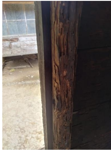
Gambar 13. Bagian kusen jendela terkikis berrongga yang tidak beraturan
